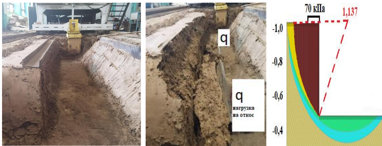
Рисунок 4.1 – Величина запаса устойчивости при вертикальном откосе канала с распределенной нагрузкой на берме недостаточна в данных условиях
