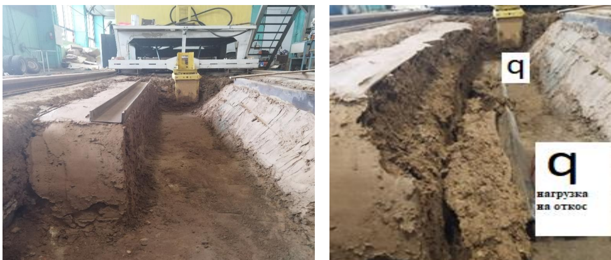
Рисунок 3.13 – Разрушение вертикального откоса канала с распределенной нагрузкой по полке швеллера
