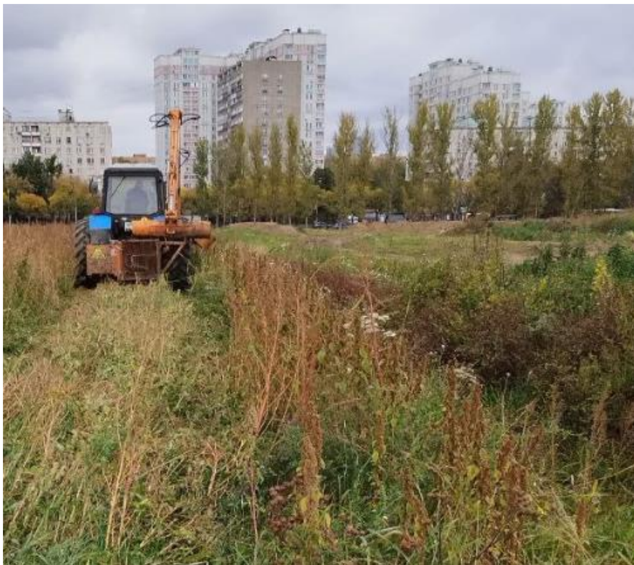
Рисунок 3.30 – Состояние осушительного канала и его бермы перед очисткой
